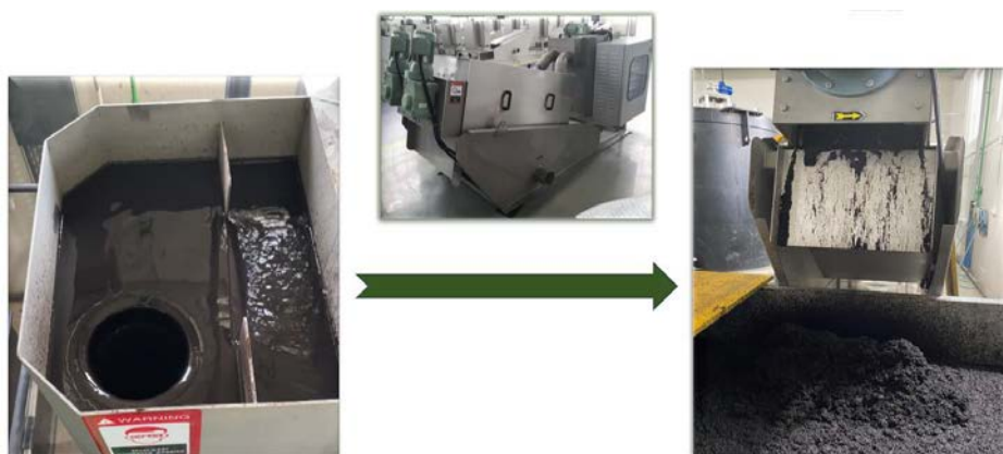
Slika 6. Dehidracija mulja Figure 6. Sludge dehydration
